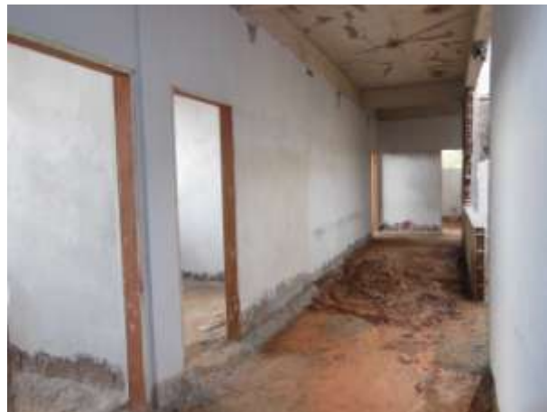
PC-7.3.12 - Alvenaria rebocada, marcos assentados e piso não executado
