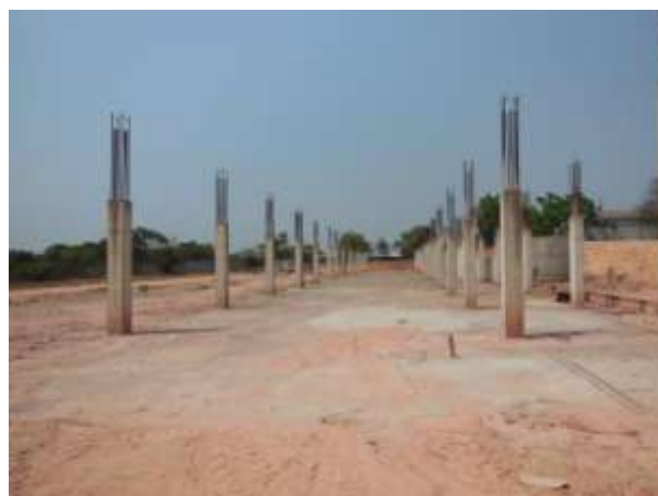
PC-7.1.12 - Piso e pilares do 1º pavimento da ala sul (etapa paralisada e ferragem exposta)
