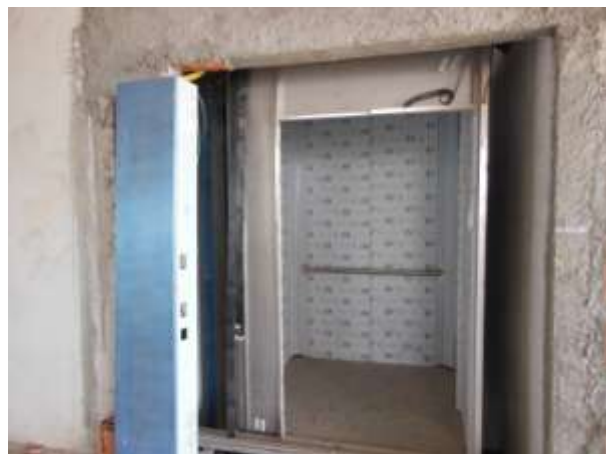
PC-7.1.8 - Elevadores (cabine)
