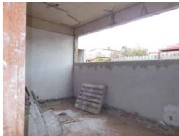
PC-7.3.8 - Cômodos sem esquadrias
