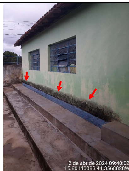
Figura 27 - Detalhe de manchas de umidade na parede, lado externo
