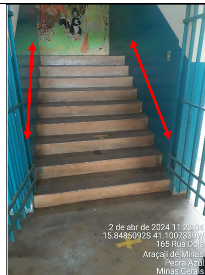
Figura 3 - Detalhe de escada sem corrimão
