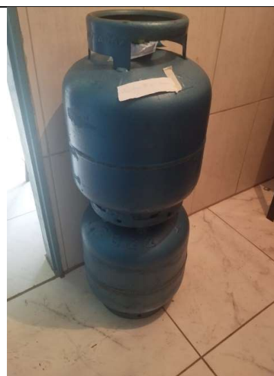
Figura 41 - Detalhe de armazenamento irregular de dois botijões de GLP no interior do prédio
