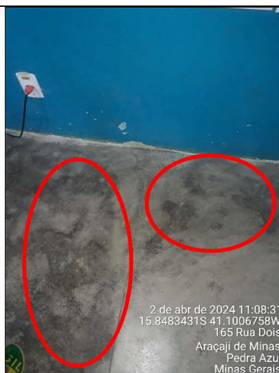
Figura 7 - Detalhe de manchas no piso da sala e aula
