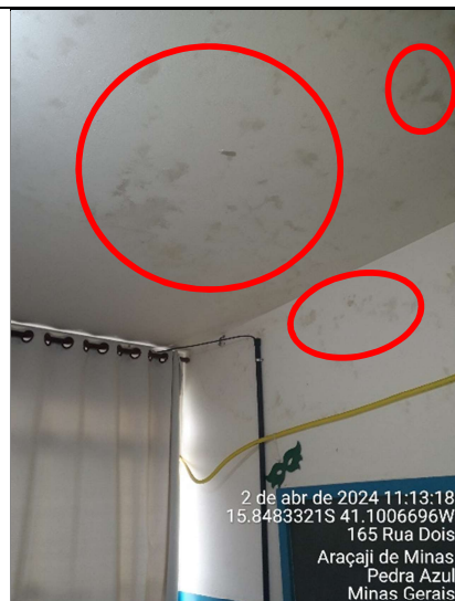
Figura 15 - Detalhe de manchas de umidade na laje e parede da sala de aula
