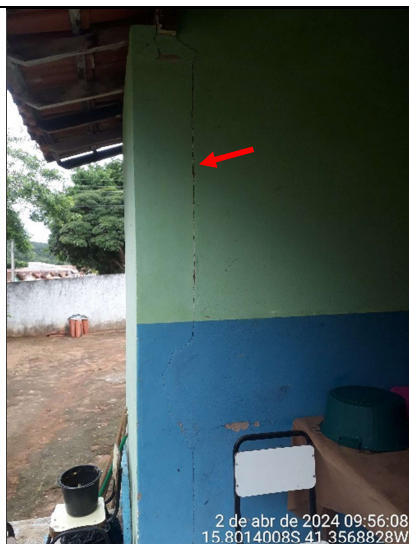
Figura 32 - Detalhe de trinca na parede, lado externo
