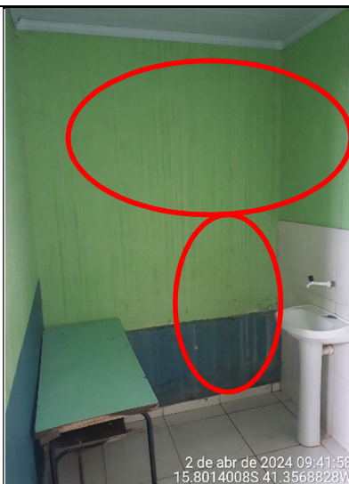
Figura 37 - Detalhe de manchas de infiltração na parede
