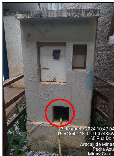
Figura 5 - Detalhe de cabos elétricos aparentes
