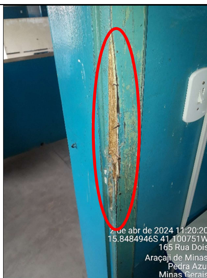
Figura 13 - Detalhe de batente danificado da sala de aula
