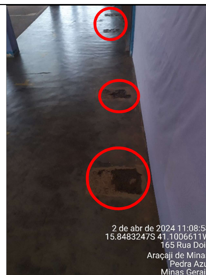
Figura 6 – Detalhe de manchas no piso do pátio
