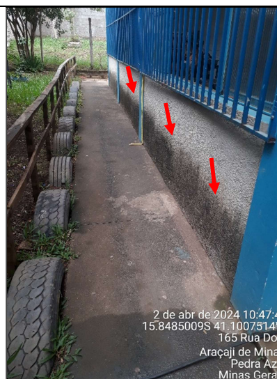
Figura 8 - Detalhe de manchas de umidade na parede, lado externo
