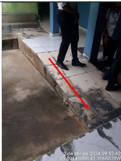
Figura 35 - Detalhe de piso liso e manchado na rampa interna
