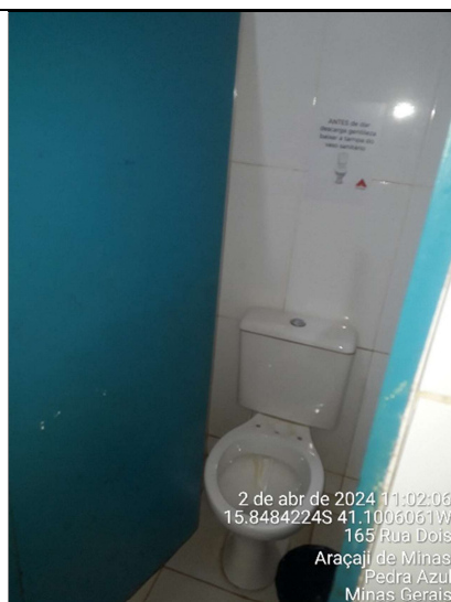
Figura 12 - Detalhe de bacia sanitária sem assento
