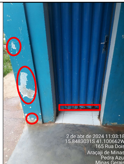
Figura 11 - Detalhe de desgaste na pintura da parede e ferrugem na parte inferior da porta do banheiro
