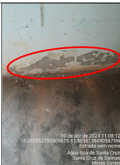
Figura 25 - Desgaste na pintura da sala de aula
