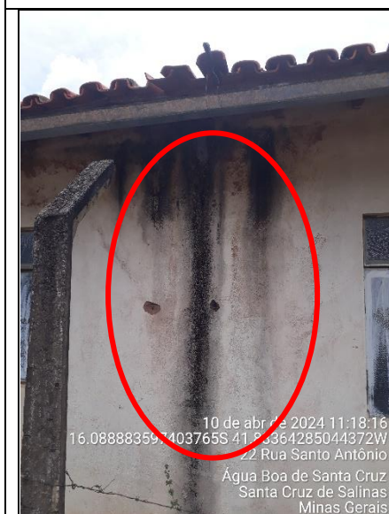
Figura 24 - Detalhes das manchas de umidade e buracos na parede, lado externo
