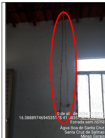
Figura 33 - Detalhe de cabo elétrico aparente
