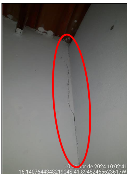
Figura 6 - Detalhe de trinca na parede, lado interno
