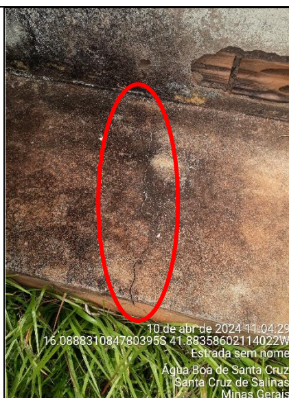
Figura 31 - Detalhe de trinca na calçada
