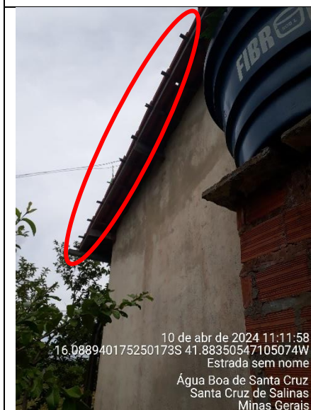
Figura 30 - Detalhe do destelhamento do beiral
