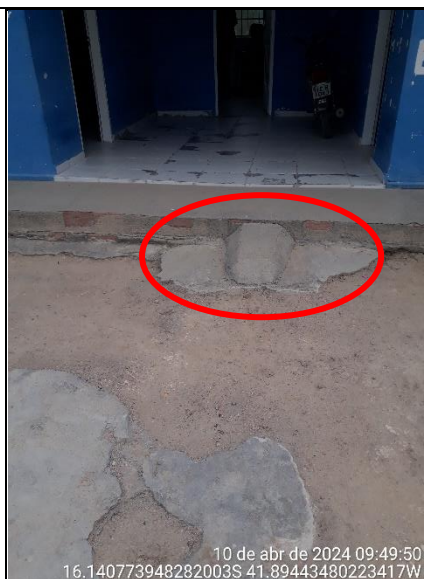
Figura 3 - Detalhe de elemento de concreto executado para facilitar o acesso, porém com dimensões e acabamentos em desacordo com a Norma.
