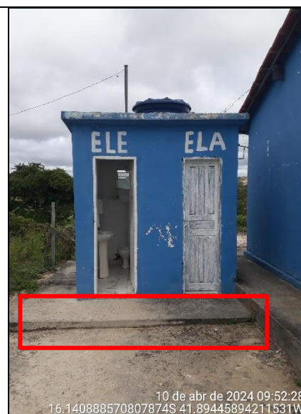
Figura 8 - Detalhe de desnível da calçada para acesso aos banheiros
