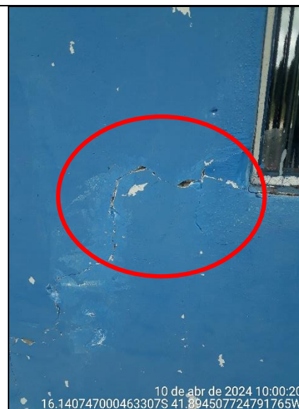
Figura 5 - Detalhe de trinca na parede, lado externo
