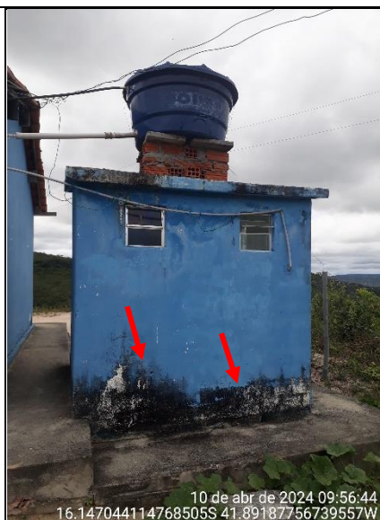
Figura 9 – Detalhe de umidade na parede do banheiro, lado externo
