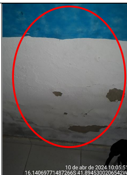
Figura 7 - Detalhe de desgaste na pintura da parede da sala de aula
