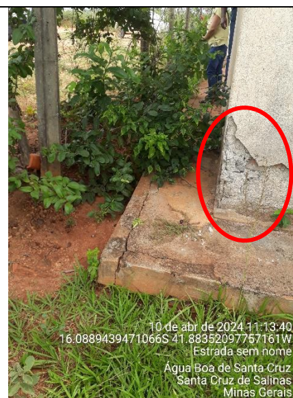
Figura 23 - Detalhe de problema no revestimento da parede, lado externo
