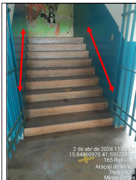
Figura 3 - Detalhe de escada sem corrimão
