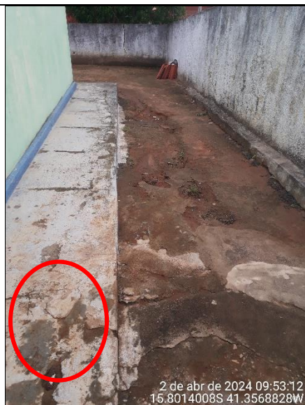
Figura 33 - Detalhe de trincas e manchas na calçada externa
