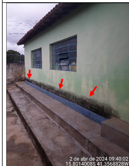
Figura 27 - Detalhe de manchas de umidade na parede, lado externo
