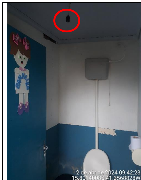
Figura 24 - Detalhe da ausência de lâmpada no banheiro feminino
