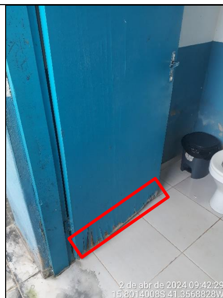
Figura 29 - Detalhe de desgaste por umidade da porta do banheiro
