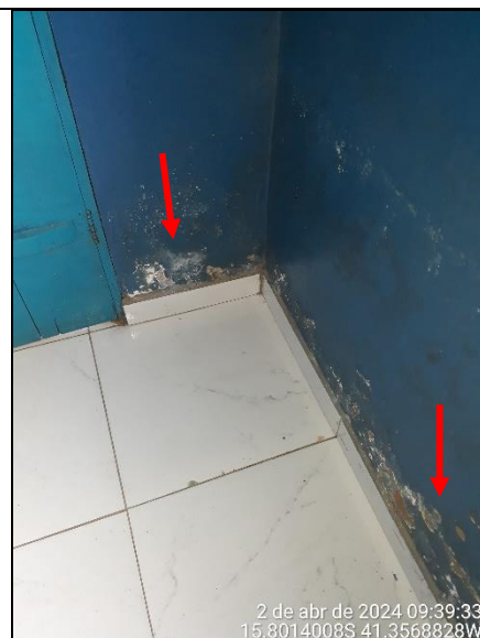
Figura 26 - Detalhe de desgaste na pintura da sala de aula
