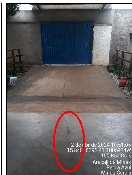
Figura 9 - Detalhes de trinca no piso do pátio
