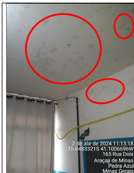
Figura 15 - Detalhe de manchas de umidade na laje e parede da sala de aula
