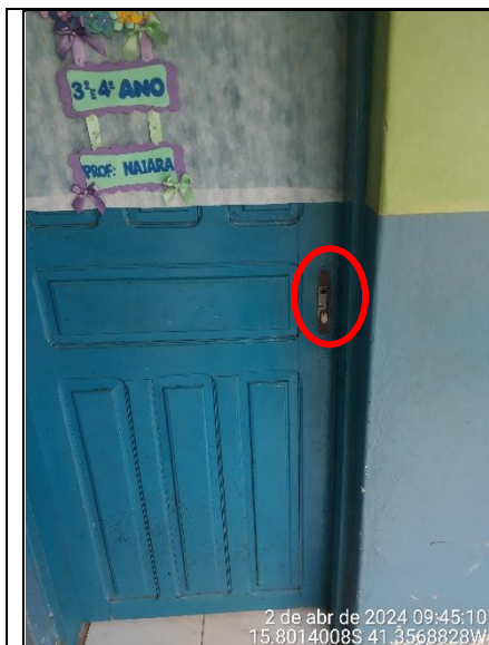
Figura 36 - Detalhe da porta sem fechadura
