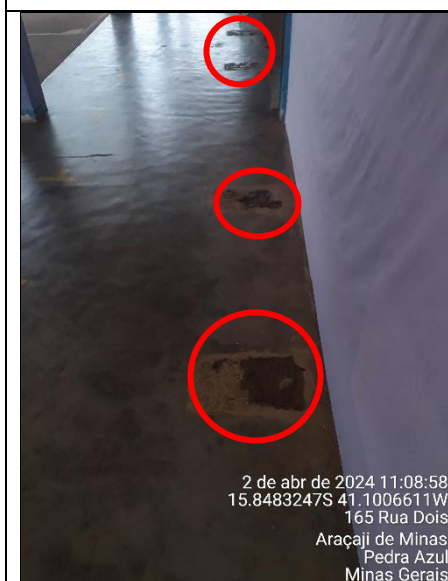
Figura 6 - Detalhe de manchas no piso do pátio
