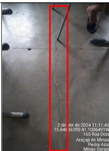
Figura 10 - Detalhe de trinca e remendo no piso da sala de aula
