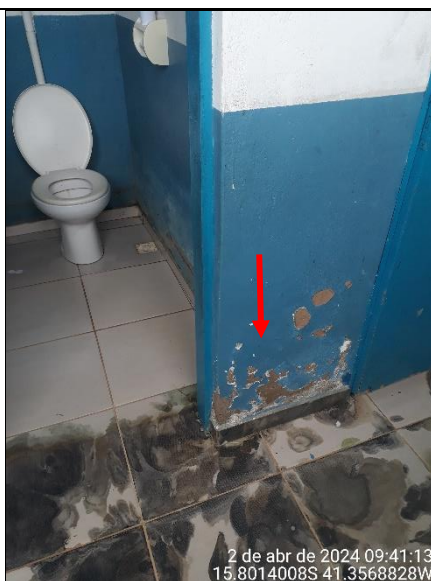
Figura 28 - Detalhes de manchas no piso e desgaste da pintura da parede
