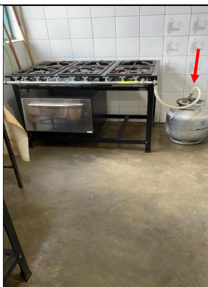
Figura 22 - Detalhe do botijão de gás no fogão e forno
