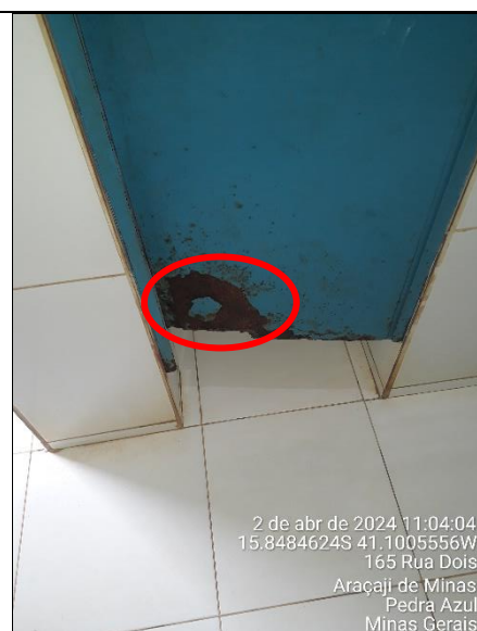
Figura 14 - Detalhe de ferrugem na porta do box do banheiro
