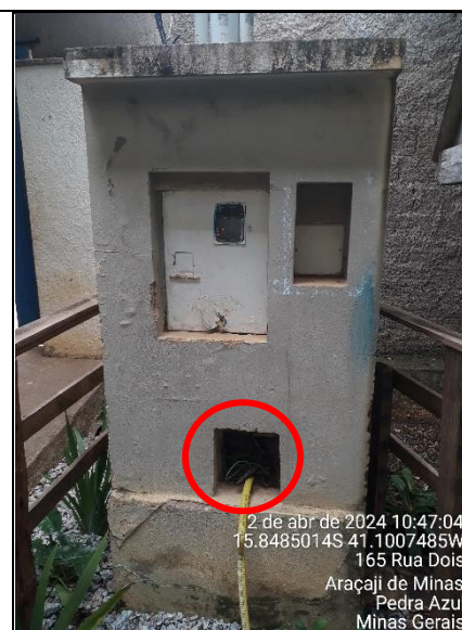
Figura 5 - Detalhe de cabos elétricos aparentes
