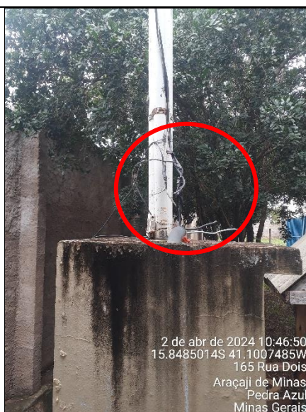
Figura 4 - Detalhe de cabos elétricos aparentes e com remendos
