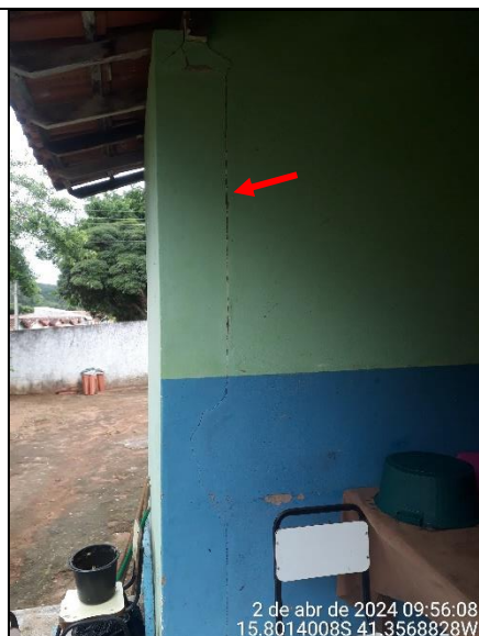
Figura 32 - Detalhe de trinca na parede, lado externo
