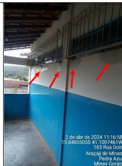
Figura 20 - Detalhe dos locais que necessitam de pintura
