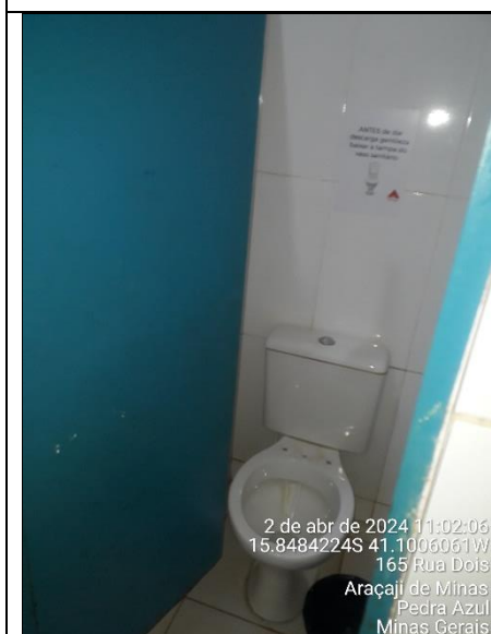
Figura 12 - Detalhe de bacia sanitária sem assento
