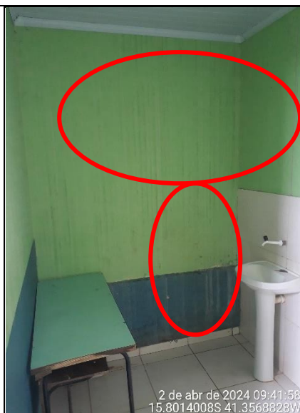
Figura 37 - Detalhe de manchas de infiltração na parede
