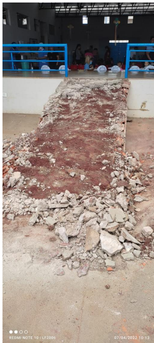
Figura 2c – Adequação de rampa
