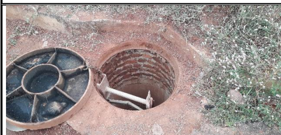
Foto 14 – Poço de visita – Passagem da rua Roraima sobre a rede de drenagem
