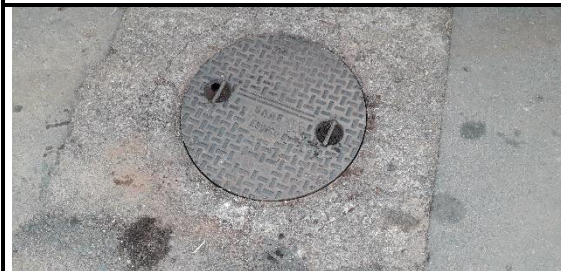
Foto 6 – Tampa de poço de visita – Altura da rua João P Barbosa
