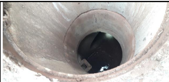
Foto 7 – Chaminé do poço de visita – Altura da Rua João P Barbosa
