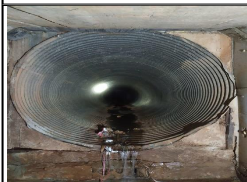
Foto 17 – Detalhe do encontro do tubo ARMCO com a galeria de 1,80m – Passagem sob a rua Roraima. Não demolida – Mal acabado.
