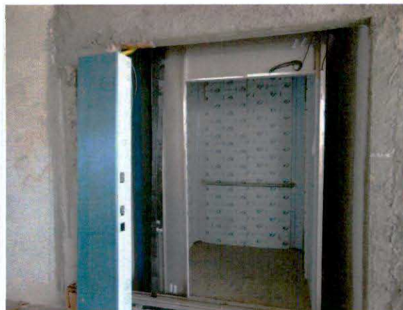
PC-7.1.8 - Elevadores (cabine)
