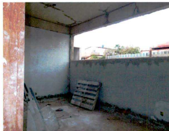
PC-7.3.8 - Cômodos sem esquadrias
