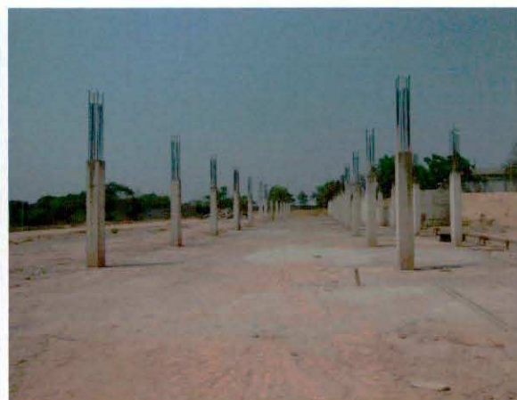
PC-7.1.12 - Piso e pilares do 1º pavimento da ala sul (etapa paralisada e ferragem exposta)
