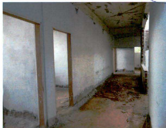
PC-7.3.12 - Alvenaria rebocada, marcos assentados e piso não executado
