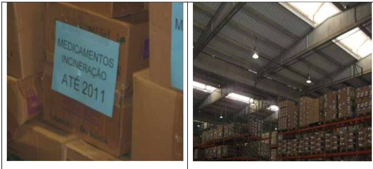
Figura 1 – Na sequência, fotos de perdas medicamentos com data de 2011, CAD/Farmácia de Minas – junho/2012 e de frestas no telhado no CAD/Farmácia de Minas – junho/2012
