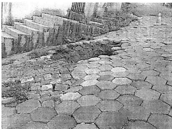
AFUNDAMENTO DE SOLO, PROBLEMAS DE DRENAGEN, EXCESSO DE UMIDADE E INFILTRAÇÃO.
