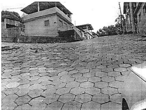
AFUNDAMENTO DO SOLO E PRESENÇA DE UMIDADE.
