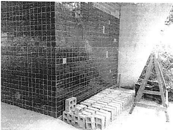
SINAIS DE COMPLETO ABANDONO.
