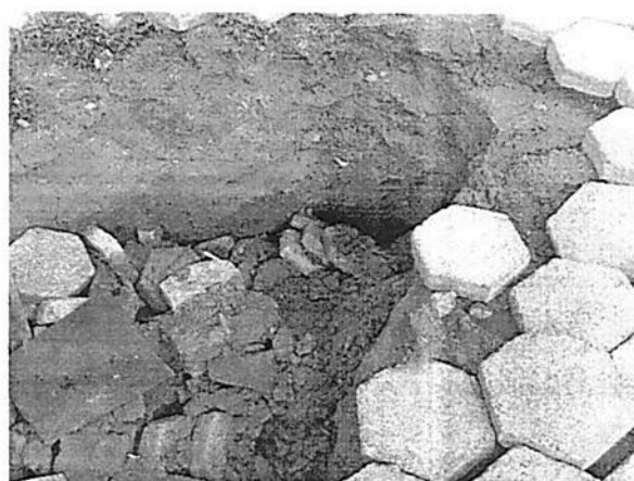
FENDA ABERTA NA VIA, DEIXANDO EM ESTADO CRITICO, E COM ALTO RISCO AOS MORADORES.
