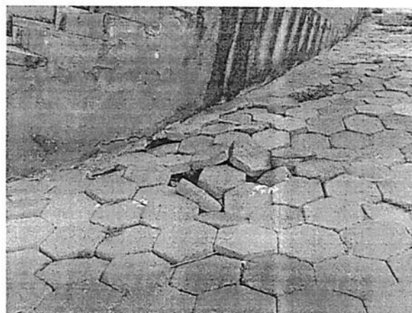
COMPRESSÃO DA SARGETA PELO AFUNDAMENTO DO SOLO.
