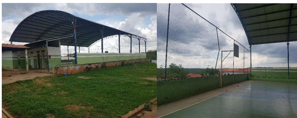
Figura 33: Fotos da EM Márcia Marília, zona urbana. A pintura da quadra de esportes está danificada. Trabalho de campo em 21/11/2017
