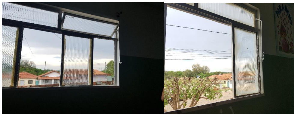
Figura 3: Fotos da EM Márcia Marília. Janelas danificadas e sem vidro. Trabalho de campo em 21/11/2017 - Fonte: TCE/MG
