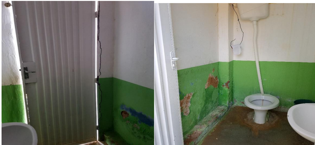
Figura 17: Fotos da EM Érico Veríssimo. Pintura danificada/infiltrações/trinca na parede. Trabalho de campo em 23/11/2017 - Fonte: TCE/MG
