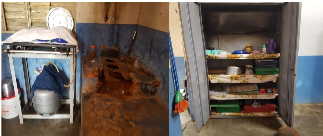
Figura 30: Fotos da EM José Lins do Rêgo. Botijão na área interna na área interna/fogão enferrujado e danificado e armários enferrujados. Trabalho de campo em 22/11/2017 Fonte: TCE/MG.
