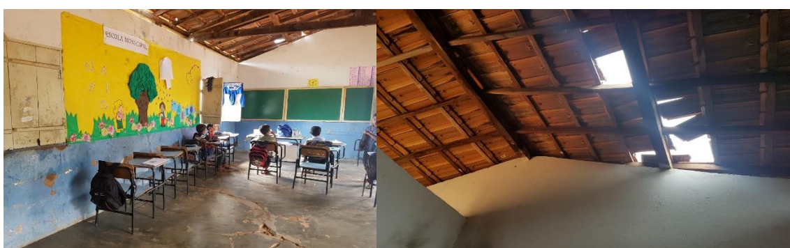
Figura 10: Fotos da EM José Lins do Rêgo. Sala de aula com telhado, piso e pintura danificada. Trabalho de campo em 22/11/2017 - Fonte: TCE/MG
