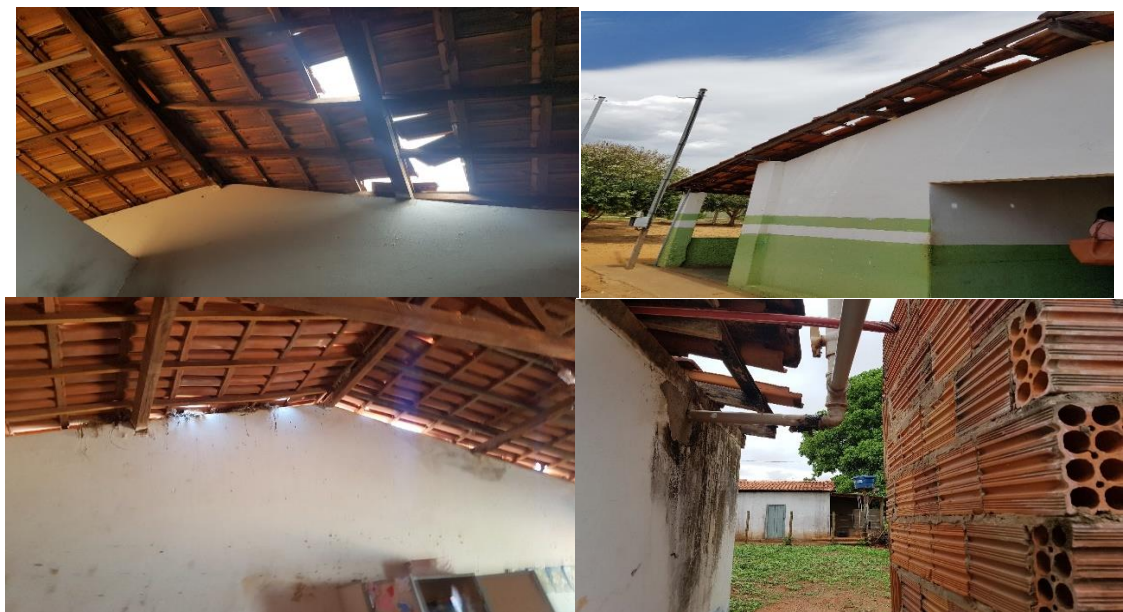
Figura 28: Fotos das escolas municipais, Telhados quebrados e infiltração na parede. Trabalho de campo em 21 a 23/11/2018. Fonte: TCE/MG
