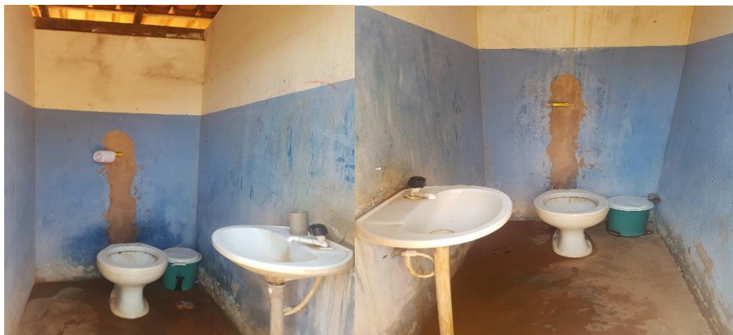
Figura 20: Fotos da EM Olavo Bilac. Banheiro com Infiltração e pintura danificada. Trabalho de campo em 22/11/2017 - Fonte: TCE/MG.
