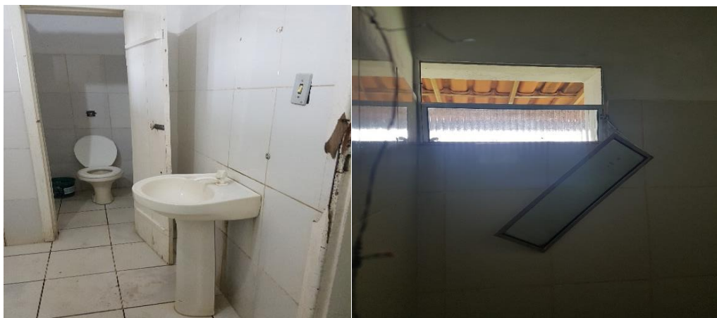
Figura 14: Fotos da EM Márcia Marília, Portas danificadas e janela quebrada. Trabalho de campo em 21/11/2017 Fonte: TCE/MG
