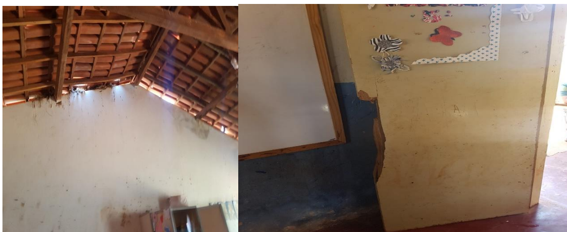
Figura 11: Fotos da EM Olavo Bilac. Sala de aula com telhado e porta danificada. Trabalho de campo em 22/11/2017 - Fonte: TCE/MG
