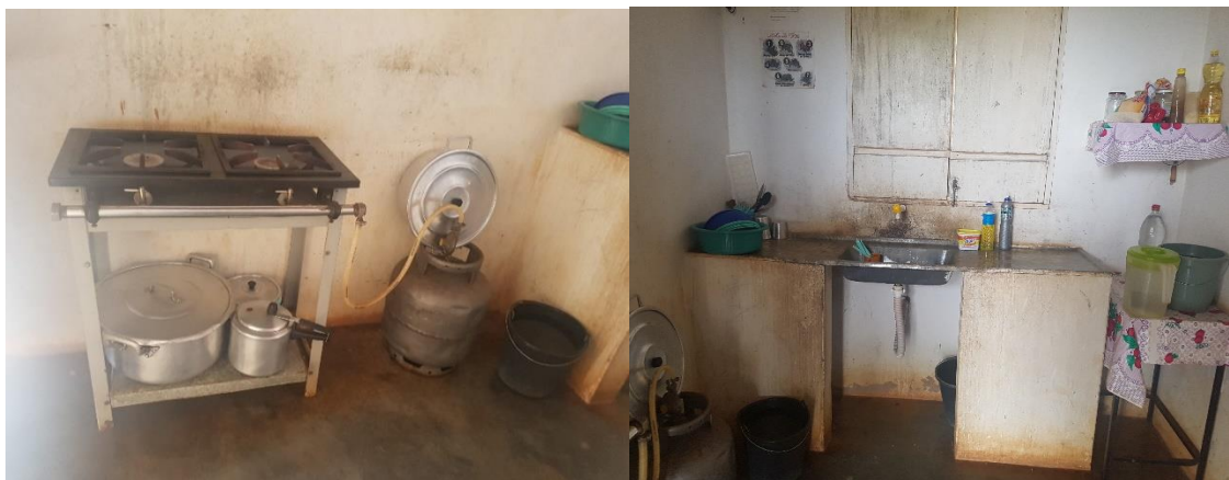
Figura 29: Fotos da EM Gustavo Corção. Botijão na área interna da cozinha. Alimentos mal acondicionados e material de limpeza ao alcance dos alunos. Trabalho de campo em 22/11/2017. Fonte: TCE/MG
