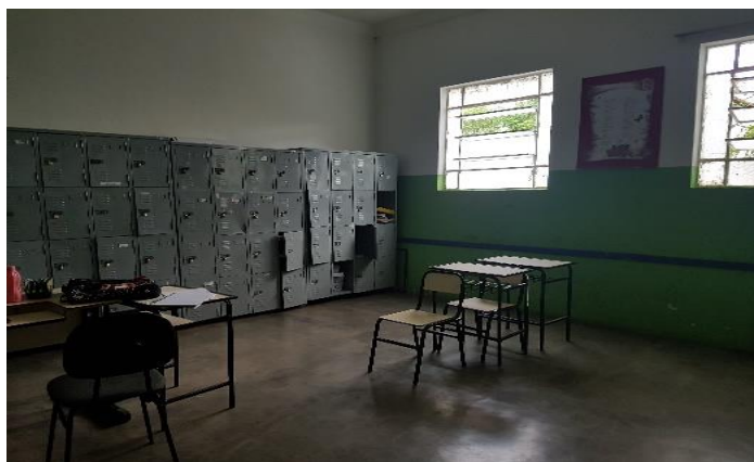
Figura 7: Fotos da EM Márcia Marília. Armários sem portas e danificados. Trabalho de campo em 21/11/2017 -Fonte: TCE/MG
