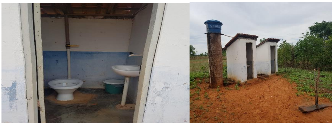
Figura 19: Fotos da EM José Lins do Rêgo. Banheiro localizado na área externa com pintura danificada. Trabalho de campo em 22/11/2017 - Fonte: TCE/MG
