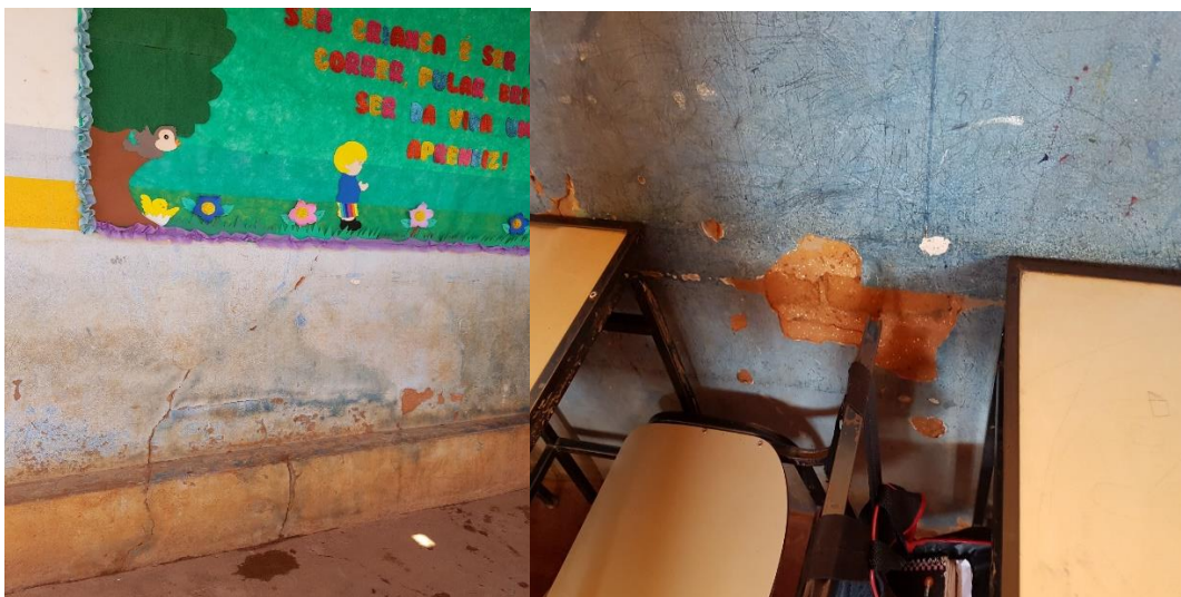
Figura 12: Fotos da EM Olavo Bilac. Paredes com trincas e pintura danificada. Trabalho de campo em 22/11/2018. - Fonte: TCE/MG
