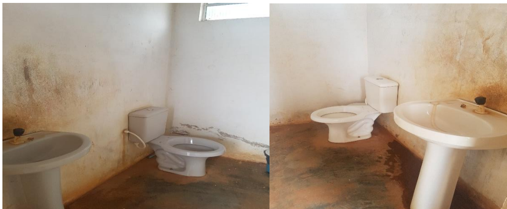
Figura 18: Fotos da EM Gustavo Corção. Banheiro com infiltração/vazamento. Trabalho de campo em 22/11/2017 - Fonte: TCE/MG
