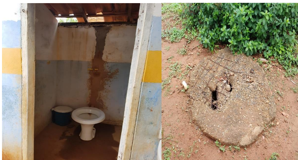
Figura 21: Fotos da EM Vitalina Pereira. Banheiro com telhado quebrado/infiltração e tampa da fossa quebrada. Trabalho de campo em 22/11/2018 – TCE/MG.
