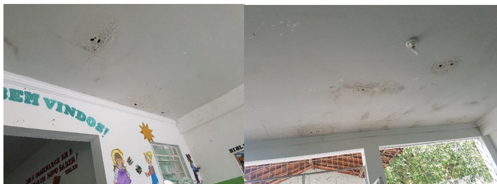
Figura 5: Fotos da EM Márcia Marília. Teto das salas de aula e saguão de entrada com infiltração. Trabalho de campo em 21/11/2017 - Fonte: TCE/MG
