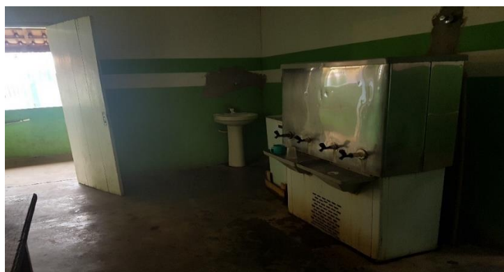
Figura 16: Fotos da EM Márcia Marília. Bebedouro em mal estado de conservação. Trabalho de campo em 21/11/2017 - Fonte: TCE/MG
