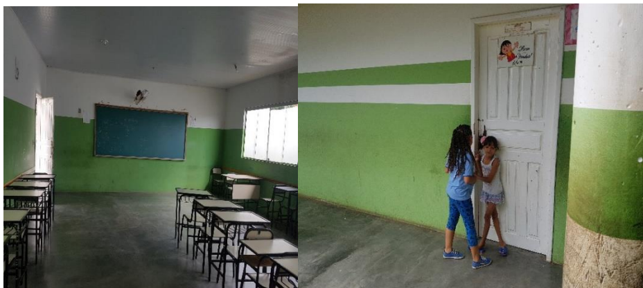
Figura 2: Fotos da EM Márcia Marília. Portas e maçanetas danificadas. Trabalho de campo em 21/11/2017 -Fonte: TCE/MG
