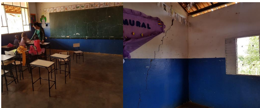
Figura 13: Fotos da EM Vitalina Pereira. Lousa, carteira, pintura danificadas e trincas na parede. Trabalho de campo em 22/11/2018 - Fonte: TCE/MG
