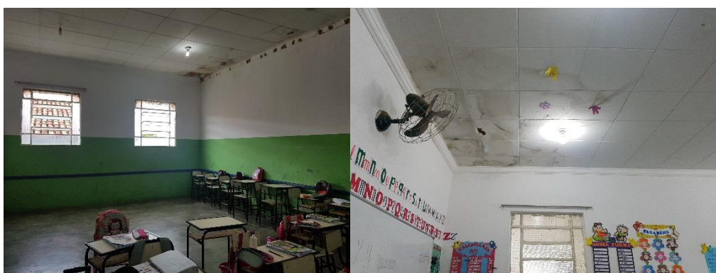
Figura 4: Fotos da EM Márcia Marília. Teto das salas de aula e saguão de entrada com infiltração. Trabalho de campo em 21/11/2017 - Fonte: TCE/MG
