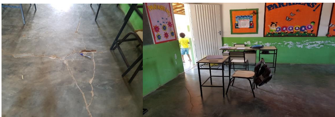
Figura 8: Fotos da EM Érico Veríssimo. Piso com trincas e pintura danificada. Trabalho de campo em 23/11/2017 - Fonte: TCE/MG
