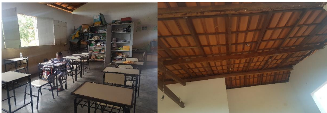
Figura 9: Fotos da EM Gustavo Corção. Armários e cadeiras/telhas/estruturas de madeira danificadas. Trabalho de campo em 22/11/2017 - Fonte: TCE/MG
