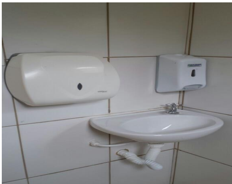
Figura 12: Fotos da EM João XXIII. Banheiros com saboneteira e toalhas para higienização das mãos fator relevante no combate a proliferação de doenças. Trabalho de campo em 23/11/2017 - Fonte: TCE/MG
