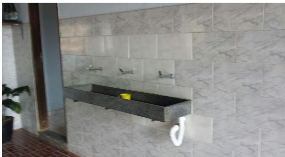
Figura 9: Fotos da EM Coronel Cláudio Gomes, zona rural. Trabalho de campo em 24/11/2017-Lavatórios não constam saboneteiras e suporte de papel para secagem das mãos. Fonte: TCE/MG
