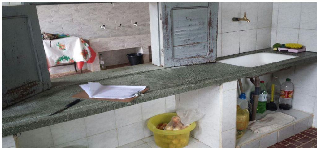
Figura 10: Fotos da EM Coronel Cláudio Gomes, zona rural. Trabalho de campo em 24/11/2017-Alimentos acondicionados fora de armários e janelas com pintura danificada - Fonte: TCE/MG
