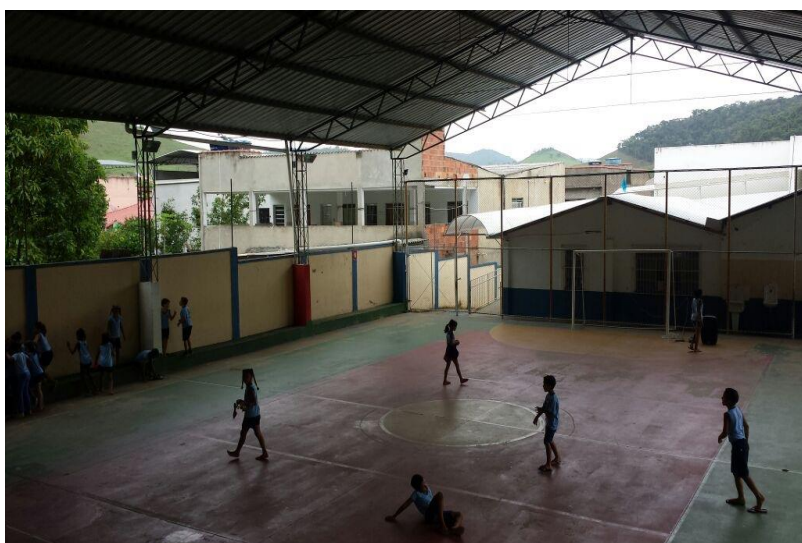
Figura 17: Fotos da EM João XXIII zona urbana. Quadra com pintura danificada. Trabalho de campo e estrutura enferrujada em 23/11/2017. Fonte: TCE/MG
