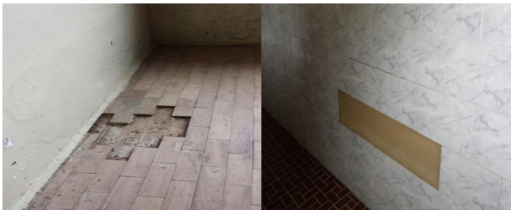
Figura 2: Fotos da EM Coronel Cláudio Gomes, zona rural. Parede e Piso danificados. Trabalho de campo em 24/11/2017 - Fonte: TCE/MG
