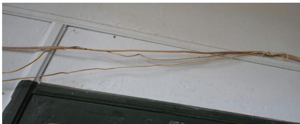
Figura 3: Fotos da EM Coronel Cláudio Gomes, zona rural. Fios expostos. Trabalho de campo em 24/11/2017 - Fonte: TCE/MG
