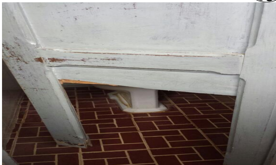
Figura 8: Fotos da EM Coronel Claudio Gomes, zona rural. Trabalho de campo em 24/11/2017 - Portas estragadas e pintura danificada. Fonte: TCE/MG
