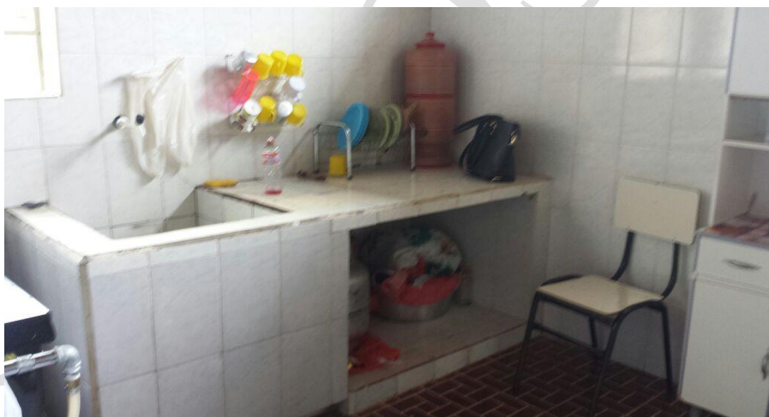
Figura 11: Fotos da EM Coronel Cláudio Gomes, zona rural. Trabalho de campo em 24/11/2017-Alimentos acondicionados fora de armários expostos à ação do tempo e insetos e que podem acarretar risco aos alimentos - Fonte: TCE/MG
