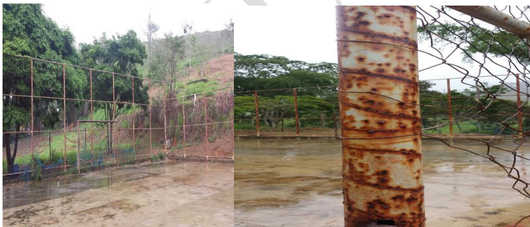
Figura 18: Fotos da EM Coronel Cláudio Gomes, zona rural. Barras de ferro e alambrado enferrujados. Trabalho de campo em 24/11/2017 - Fonte: TCE/MG
