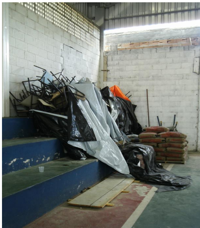
Figura 8 - Restos de construção dentro da quadra
