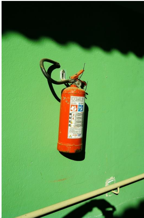
Figura 12 - Extintor de incêndio
