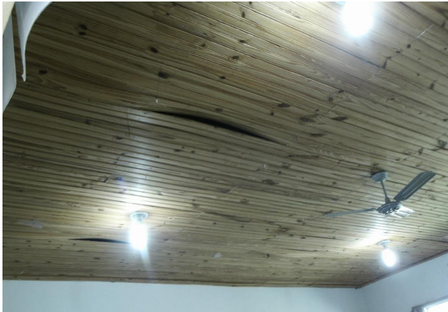
Figura 22 - Forro do teto danificado
