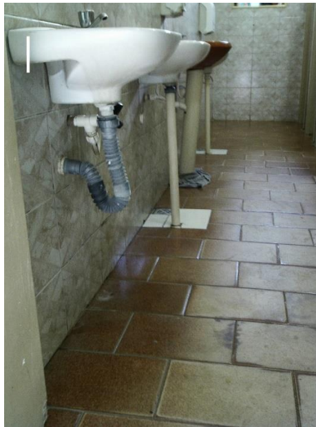
Figura 16 - Banheiro com vazamentos e piso danificado
