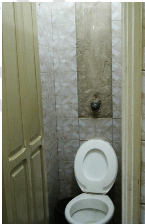
Figura 17 - Banheiro sem azulejos
