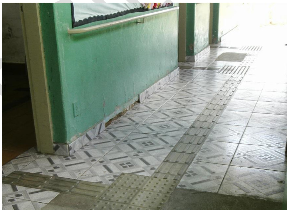
Figura 6 - Ausência do rodapé
