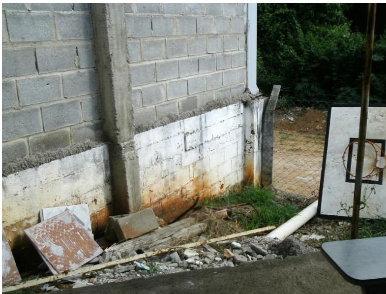
Figura 10 - Restos de construção ao lado da quadra
